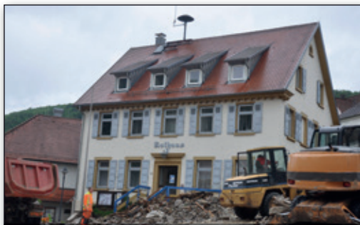
Am 29. Mai 2016 wurde Braunsbach durch ein Unwetter verwüstet
